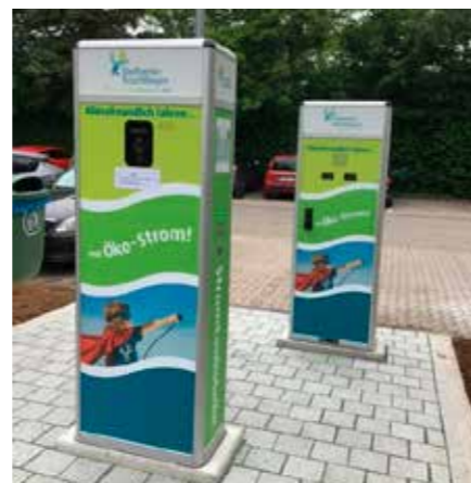
Mit zwei weiteren Strom-Ladesäulen am Parkplatz Altmühltherme leisten die Stadtwerke aktiven Beitrag zur Förderung der Elektromobilität (4 Autoladestecker mit je 22 kW Ladeleistung).
